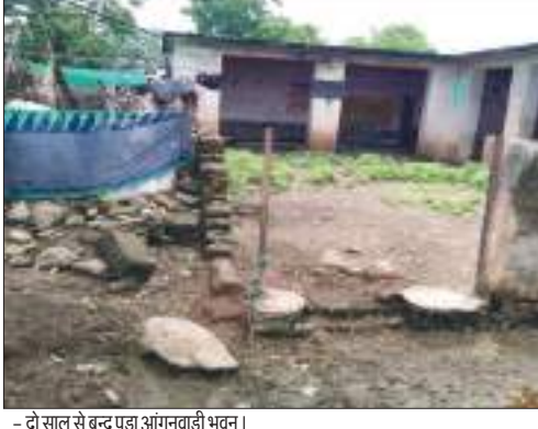
दो साल से बन्द पड़ा आंगनवाड़ी भवन।
